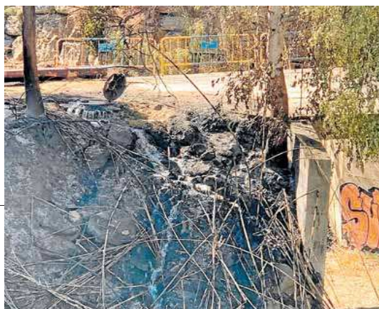
Tubería de saneamiento calcinada por las llamas. SALVADOR SALAS
